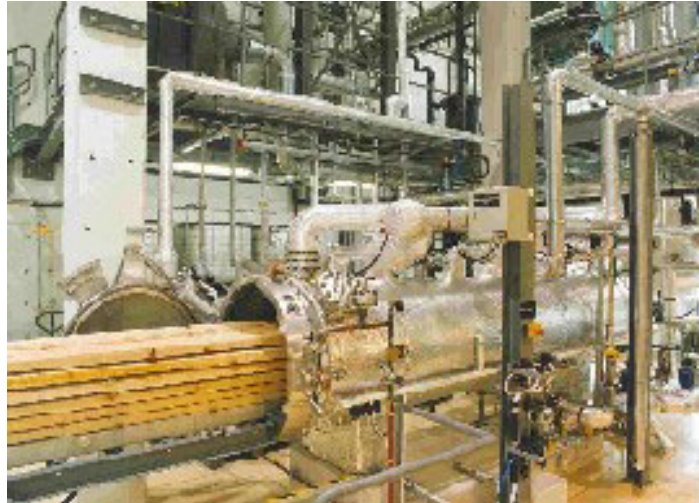
Abbildung 39 Acetylierungs-Anlage in der Industrie
